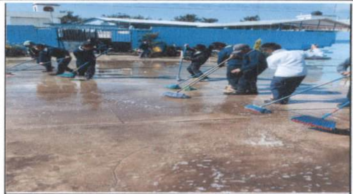
Foto 2: Reparación del patio de la Escuela por acumulación de agua en tiempo de invierno
