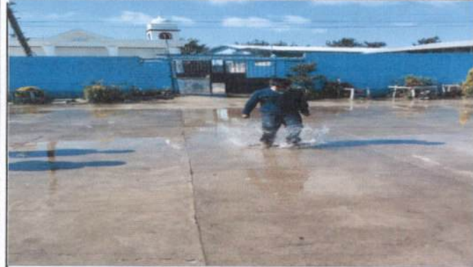
Foto 1: Reparación del patio de la Escuela por agrietamientos casados por los terremotos
