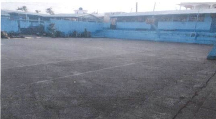
Foto 3: Reparación de drenajes para poder sacar las aguas pluviales del patio de la escuela ya que en tiempo de invierno presenta riesgo para los niños.
